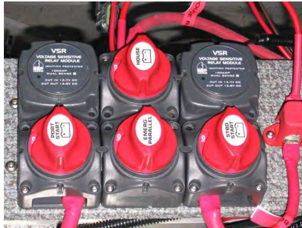
Commutateurs du système à trois batteries
